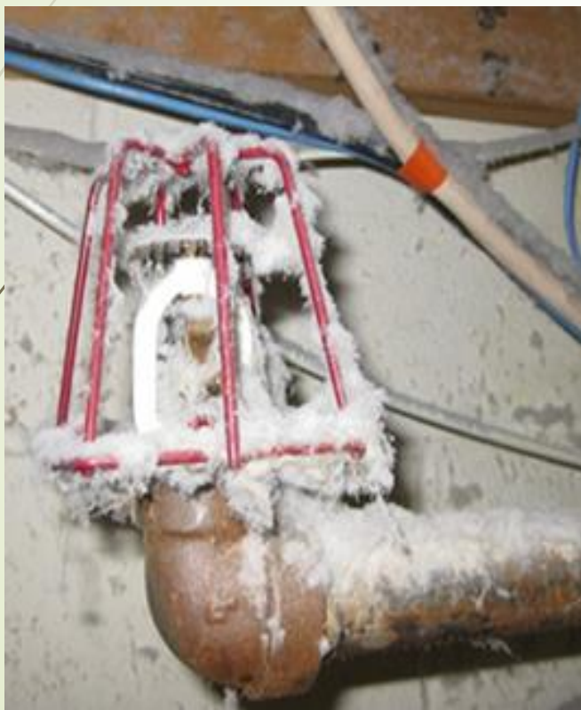
消防裝置不在有效操作狀態 《消防(裝置及設備)規例》8 i(a)
