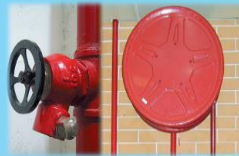
消防栓 / 喉轆系統 Hydrant / Hose Reel System
