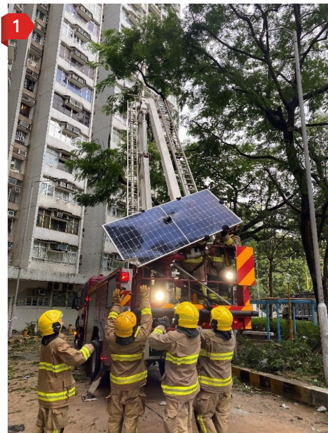
1 消防人員移除鬆脫的太陽能板。 Fire personnel remove a fallen solar panel.
