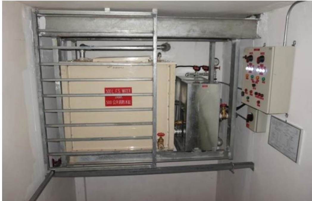
安裝於天台樓梯內部
